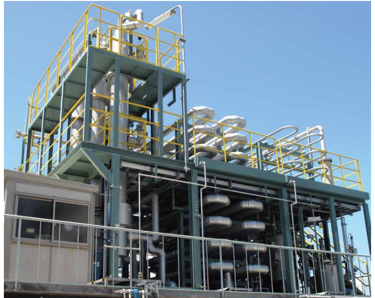
エネルギー創出型廃水処理（水熱ガス化）商用プラント
